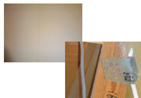
ボードや金物類の損傷や変状も見られなかった
